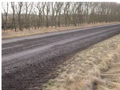
Billede 2 Kørebane tilsvinet med mudder efter gyllenedfældning (Foto: Thomas Harbo)
